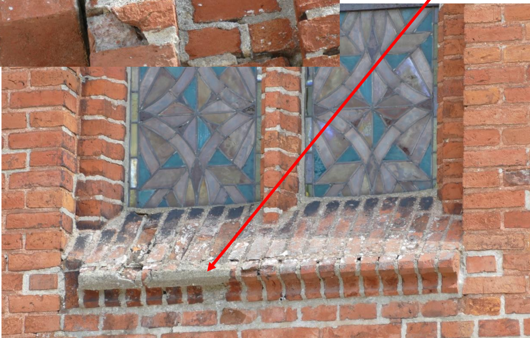
19. Zniszczony parapet „łatany” zaprawą cementową.
